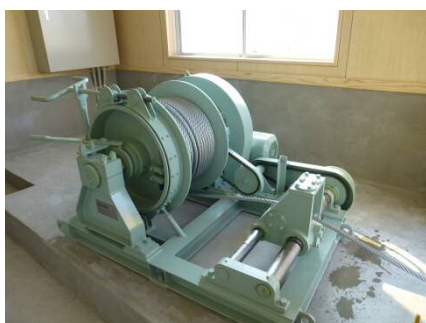
コンクリートブロックに固定されたウインチ
